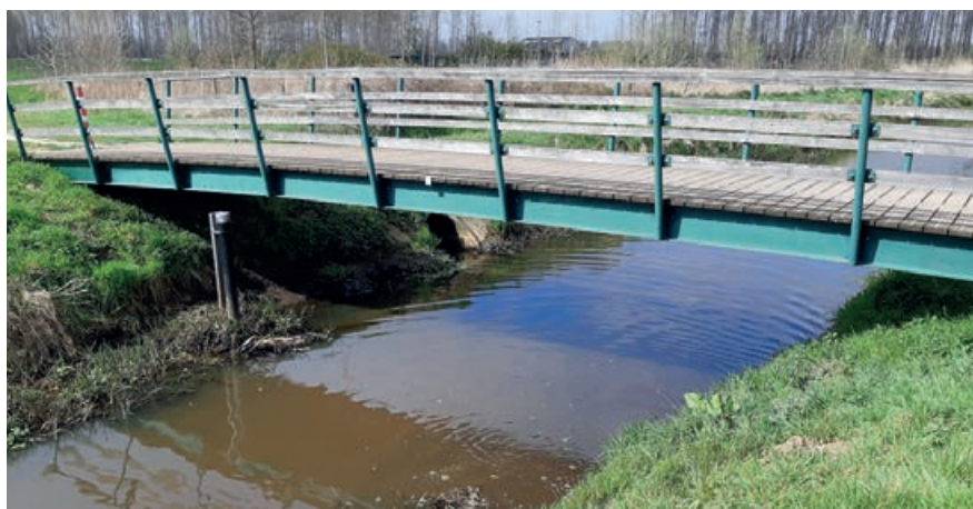
Door de IMX240 aan een brug te monteren, meet Waterschap Aa en Maas midden in de watergang zonder daarvoor kunststofkokers in het water te moeten plaatsen.
